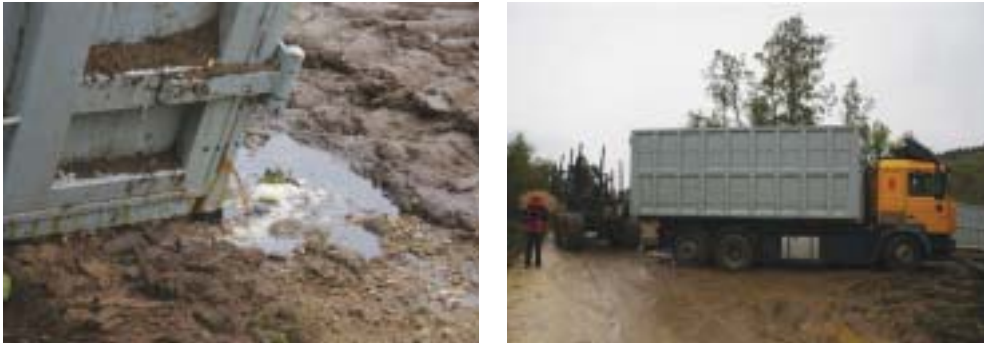
Fig. 84 y 85: Problemas operativos de transporte en tiempo lluvioso.
