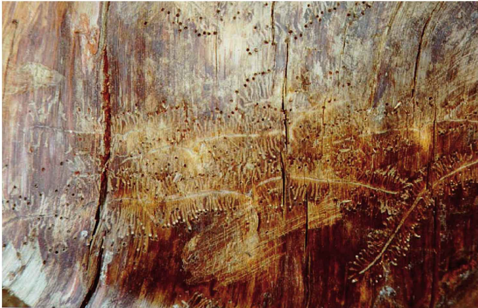
Figura 2.121. Madera con picaduras
